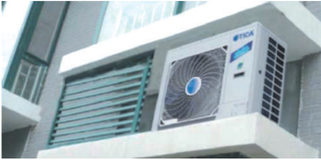
Наружный блок мини VRF-системы на фасаде жилого дома
