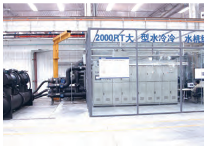
Стенд для испытаний чиллеров с водяным охлаждением мощностью до 7034 кВт (2000RT)
