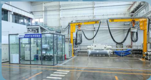
Лаборатория для проведения испытаний водоохлаждаемых чиллеров производительностью до 600 RT (2110 кВт)
